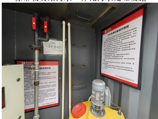
永兴收费站污水一体化污水处理设施
