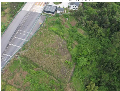
K45+600 左侧渣场现状
