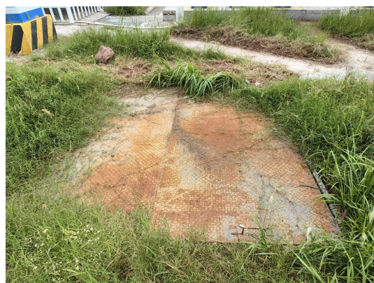
前锋服务区化粪池
