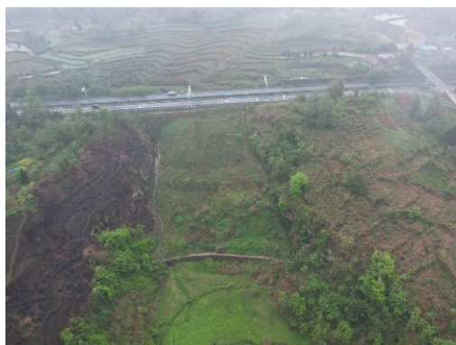
K0+820 左侧渣场现状
