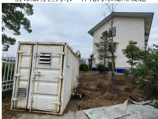
禄市收费站污水一体化污水处理设施
