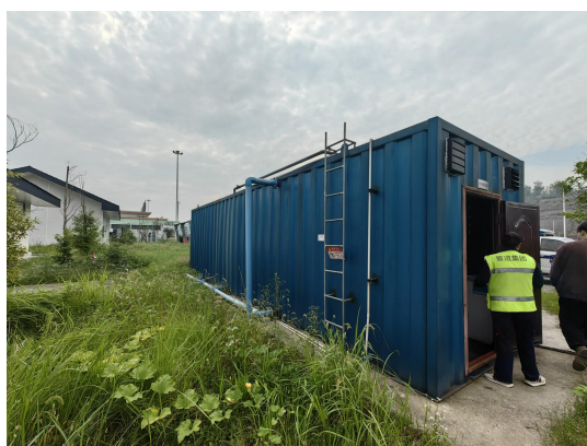
华蓥服务区污水一体化污水处理设施
