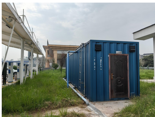
前锋服务区污水一体化污水处理设施
